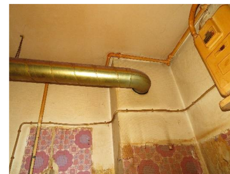
Emhætte tilsluttet sidekanal af skorsten
