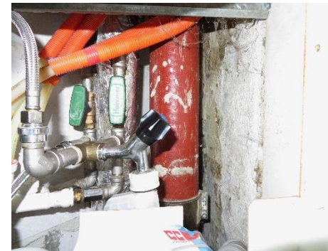
Nyere støbejerns- faldstamme i køkken
