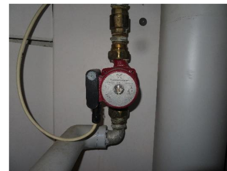
Cirkulationspumpe til varmt brugsvand
