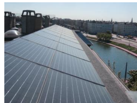
Eksempel på solcelleanlæg
