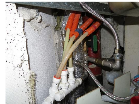
Vandinstallation i køkkenet
