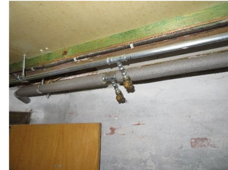
Hovedledninger i kælderen
