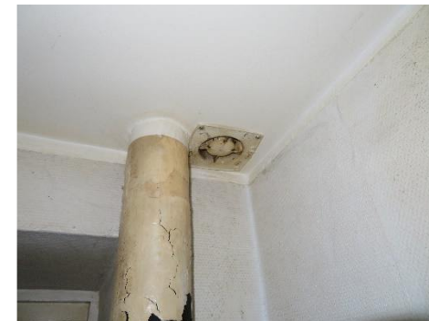
Ventilationskanal på toilet
