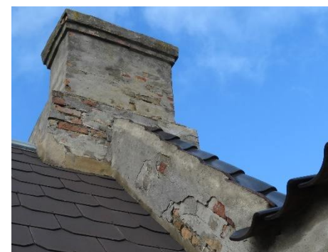
Brandkam og skorsten med skader på puds og murværk
