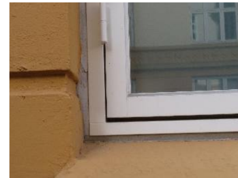
Fuger på vinduer mod gade
