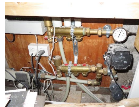
Gulvvarmeanlæg i lejlighed
