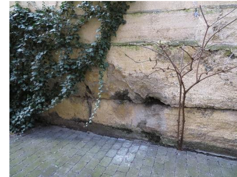
Afskalning af beton på støttemur
