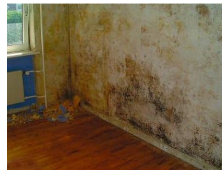
Eksempel på skade efter indvendig isolering Billedet er ikke fra jeres bygning
