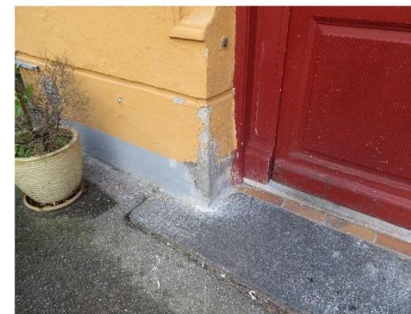
Mindre kosmetiske skader ved døre
