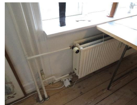
Radiator i lejlighed
