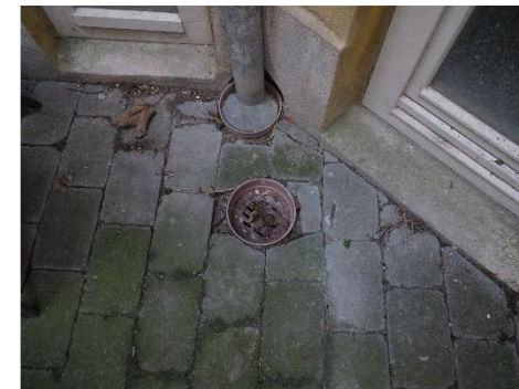
Nedløbsbrønd i gård
