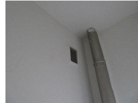
Ventilationskanal på toilet
