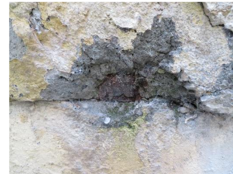
Blotlagt armering på støttemur
